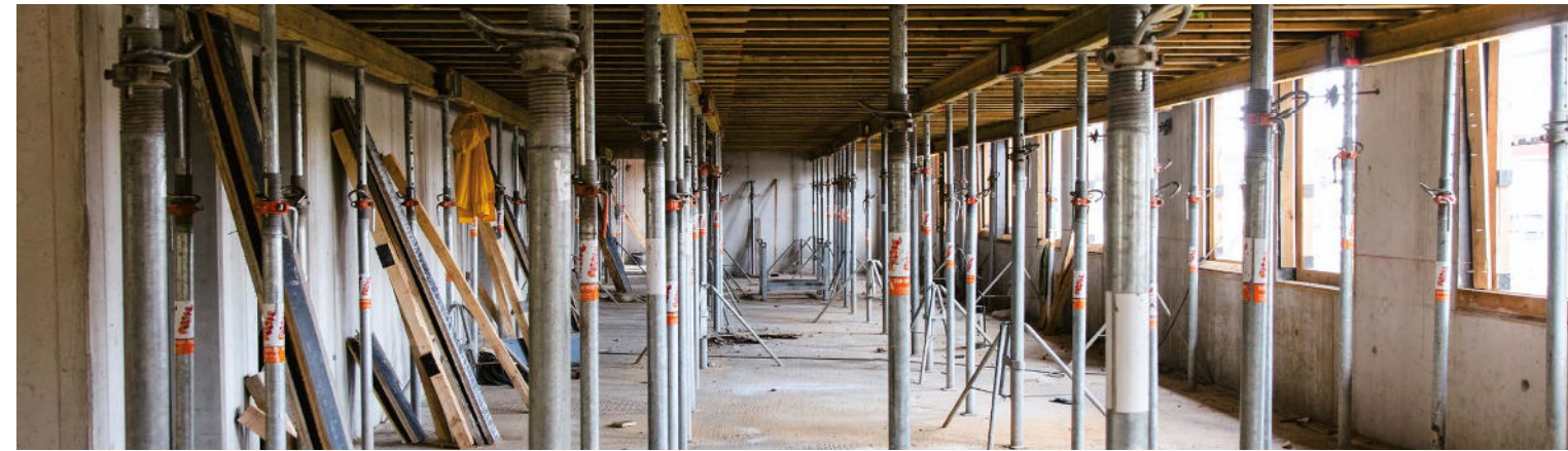
Sommer 2024: Die Fertigstellung des Rohbaus naht. Die letzte Etage soll zum Spätsommer fertiggestellt sein.
